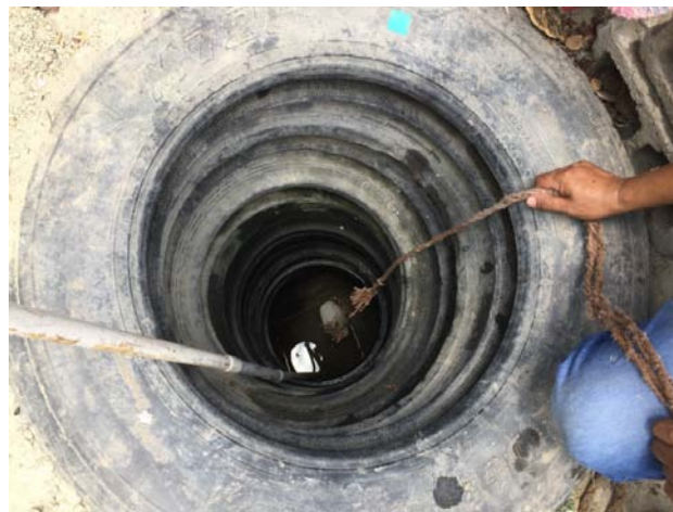
Fig. 3. Pozo doméstico formado con llantas que brindan soporte estructural. El tubo blanco de la izquierda conduce a una bomba que transporta agua desde el pozo hasta un recipiente de almacenamiento en el patio. La cuerda está unida a una cubeta para sacar el agua del pozo. Las llantas por encima del nivel del agua en el pozo a menudo contienen agua que sirve de hábitat larvario de Ae. aegypti .
